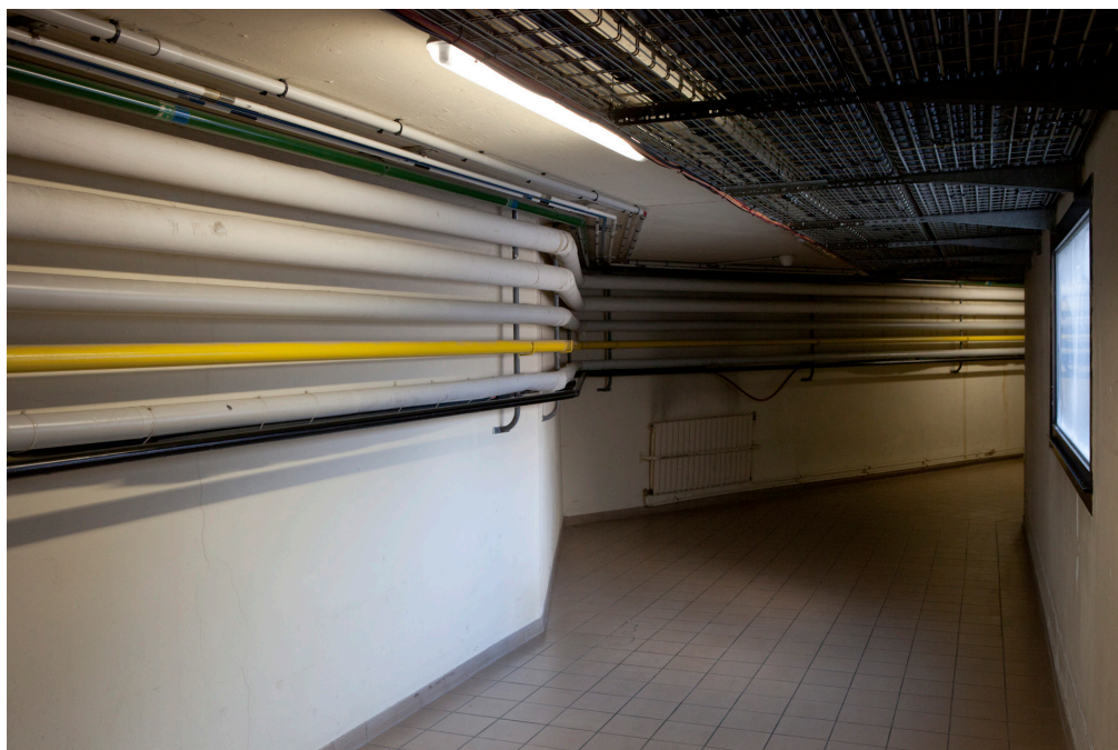
— fig.05 Sous-sols , Centre hospitalier Saint-Cyr, Villeuneuve-sur-Lot (2014).
